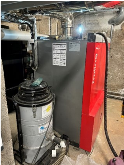
Entretien des chaudières pendant la période de chauffe
